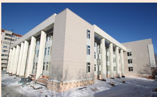
Строительство здания Ленинского районного суда г. Новосибирска (планируется ввод в эксплуатацию в 2016 году)
