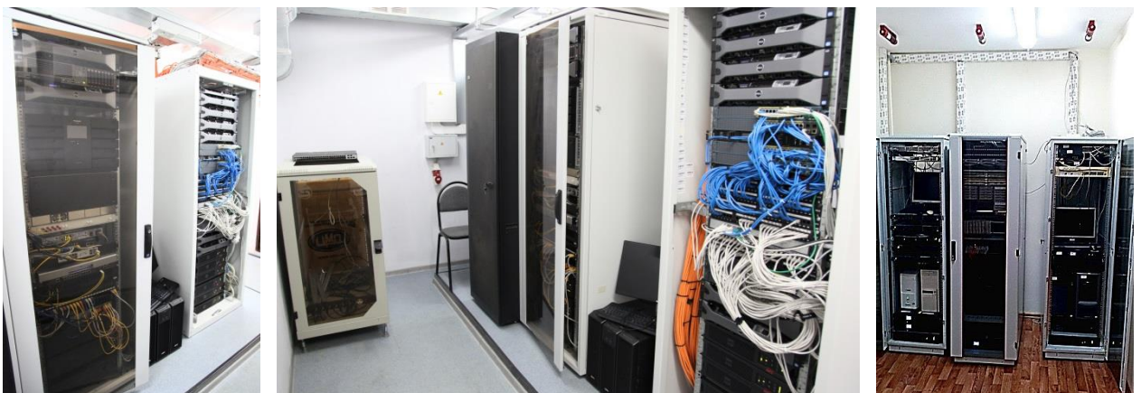
Серверное оборудование судов
