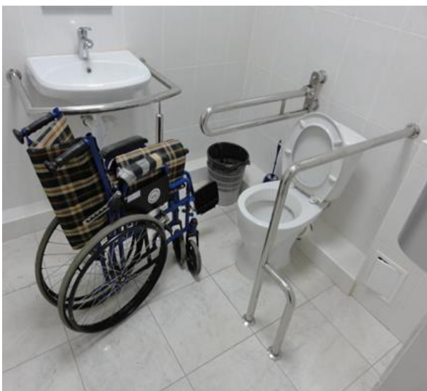
Оборудование санузла для маломобильных групп граждан в Ленинградском районном Калининградской области (комплексная проверка Управления Судебного департамента в Калининградской области в 2017 году)
