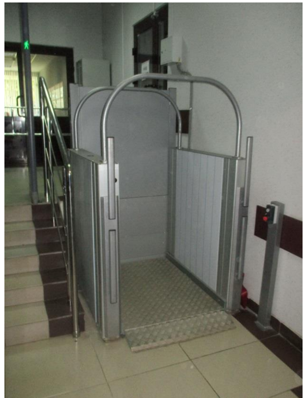
Подъемник для маломобильных групп граждан в Котельничском районном суде Кировской области (комплексная проверка Управления Судебного департамента в Кировской области в 2017 году)
