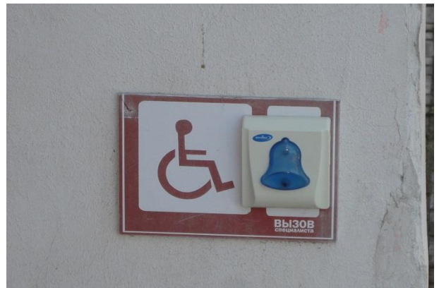
Кнопка вызова специалиста для маломобильных групп граждан на здании Мышкинского районного суда Ярославской области (комплексная проверка Управления Судебного департамента в Ярославской области в 2017 году)
