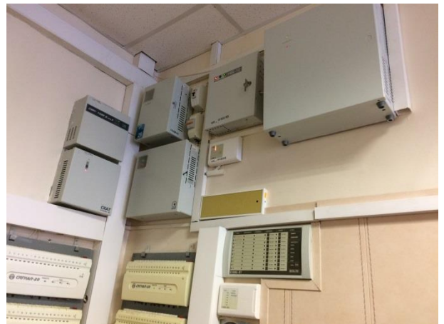
Оборудование пожарно-охранной сигнализацией
