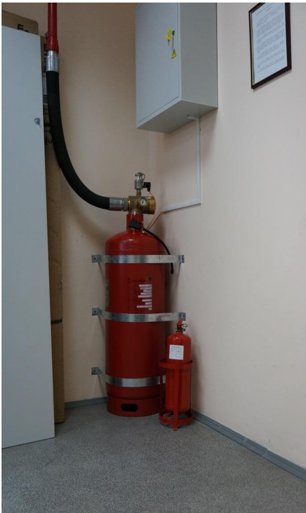
Система автономного пожаротушения
